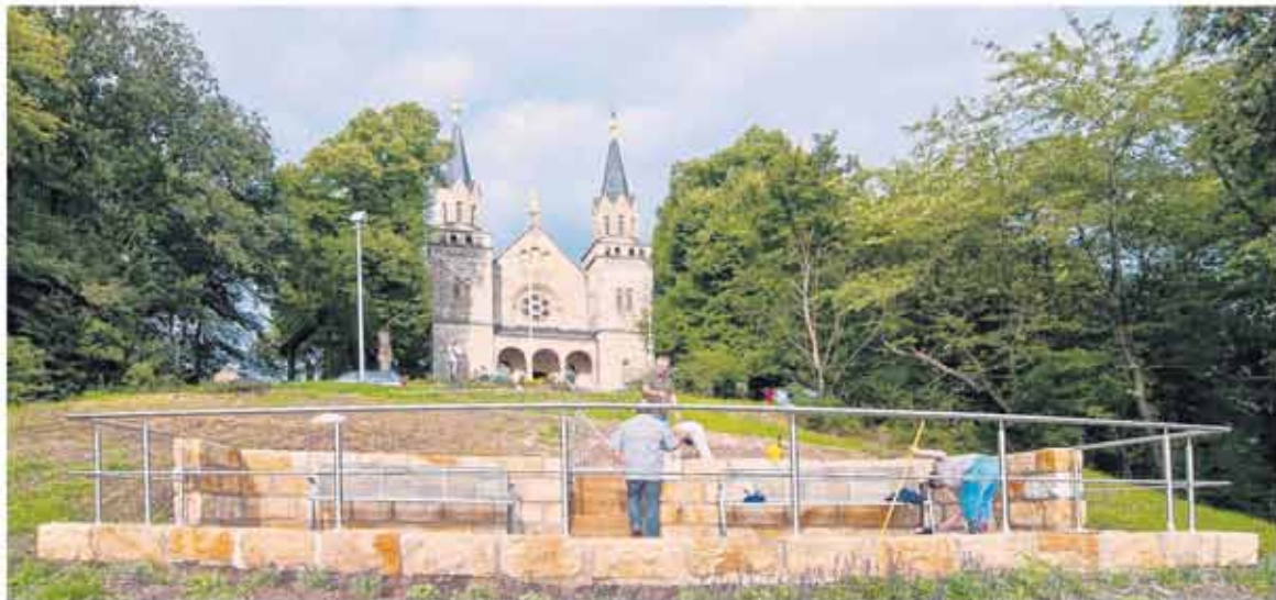
Blick nach oben: Mit der Aufstellung der Sitzbänke und der Anbringung des Geländers fand der Bau der Aussichtsplattform am Käppele dieser Tage seinen Abschluss.
